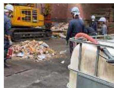
消火方法は消火器の以外に、 移動式タンクの水も使用！
